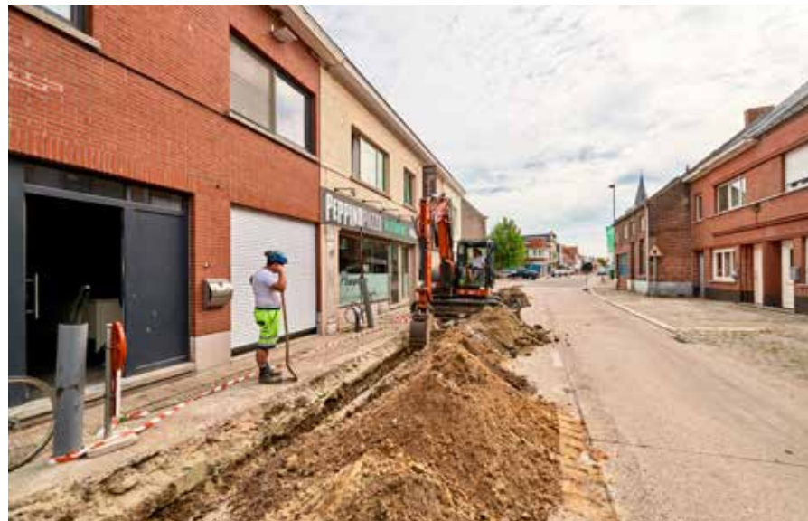
In opdracht van de gemeente Keerbergen realiseert DCA Infra momenteel een ingrijpende heraanleg van het dorpscentrum.
