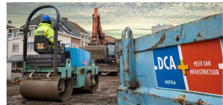
DCA Infra profileert zich als een betrouwbare partner die een gepaste oplossing biedt op maat van elke vraag: van grote openbare collectorwerken tot de aanleg van privéparkings.
